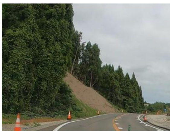
(a) 2024年の切土法面の崩壊
