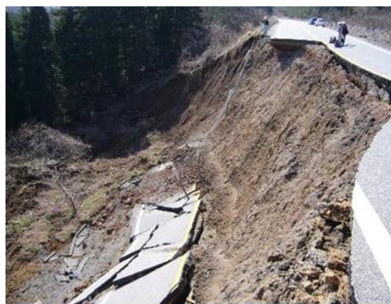
(b) 2007年の盛土法面の崩壊
