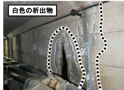
図-5 洞道側壁部における白色の析出物
