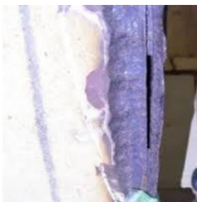
写真-1 すみ肉溶接の腐食切れの一例
