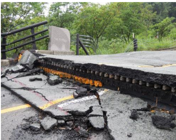
写真-1 地震により橋台パラペット部に生じた段差
