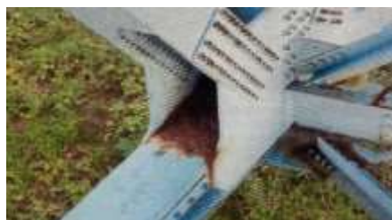
写真-1 格点部下弦材上面の腐食状況
