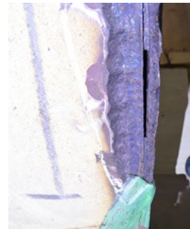
写真-1 すみ肉溶接部の腐食切れの一例
