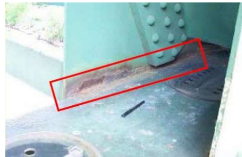
写真-1 格点部の腐食例
