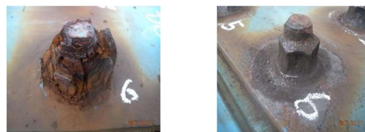
(a) ケレン前 (b) ケレン後 写真-1 腐食が進行した高力ボルト 2)
