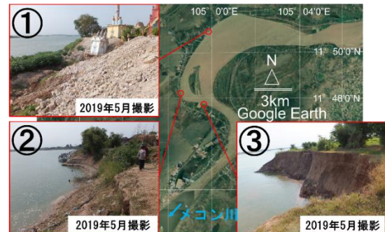
図-1 斜面崩壊現場の位置と状況
