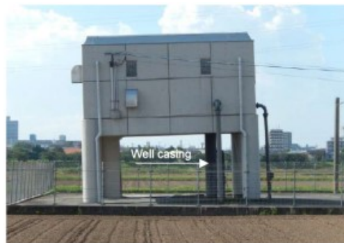
図-1 秋田水源地取水棟の被害状況
