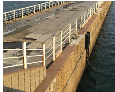
図-2 万葉ふ頭緑地護岸(伏木富山港)ボードウォーク材及びタイルの破損状況
