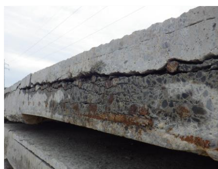
図 2 塩害によって生じた変状
