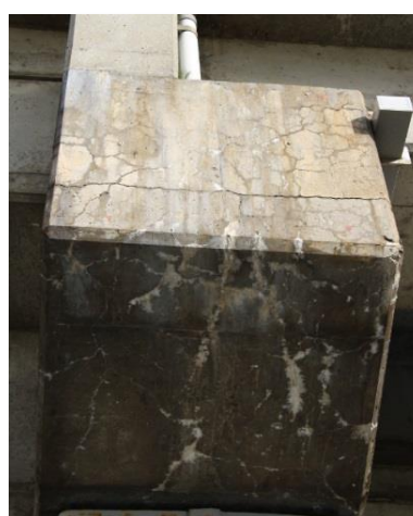
図 3 ASR によって生じた変状
