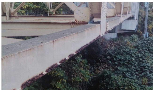
図-1 下弦材に見られる腐食状況
