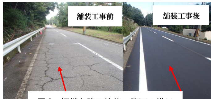
図 2 極端な路面性状の路面の様子
