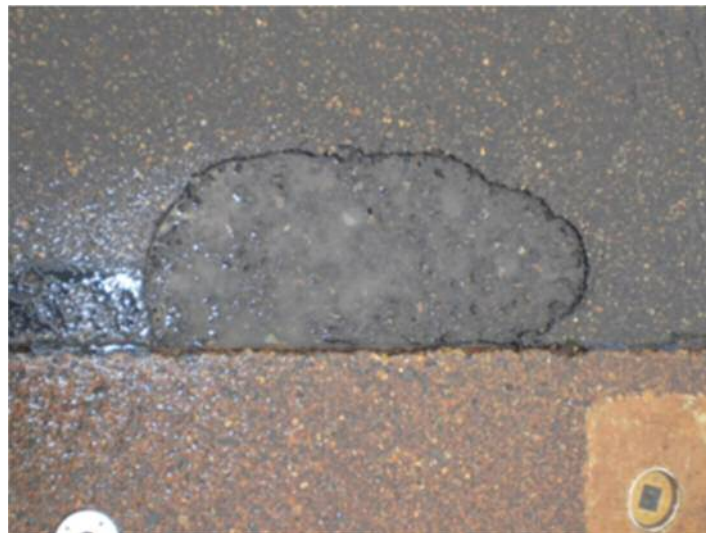
写真 1 ポットホール
