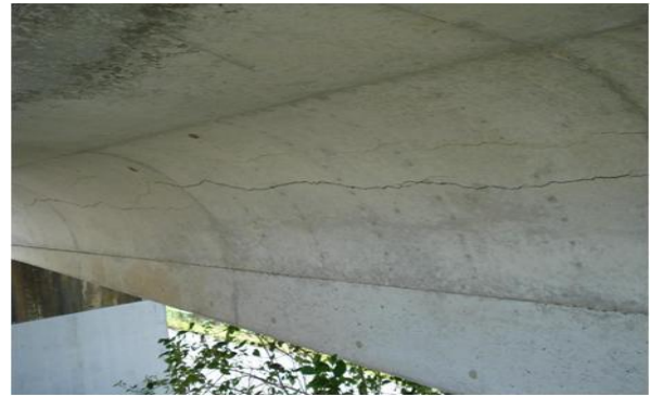
写真-1 ASRによる軸方向ひび割れ
