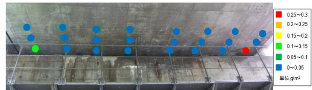
図-18 神立橋_表面拭き取り
