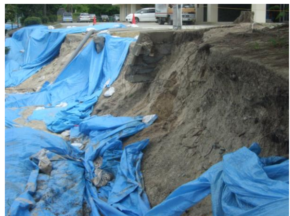
写真1 一其中学校周辺の被災状況
