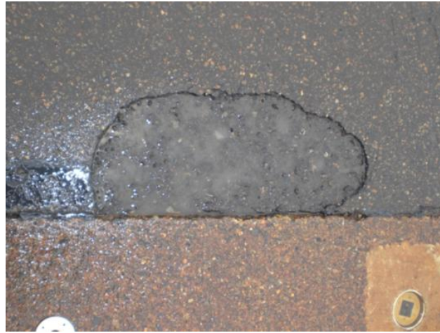
写真1 すりつけ用混合物の剥離の状況
