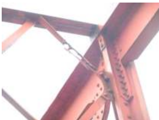
写真2 不動沢橋の劣化部分
