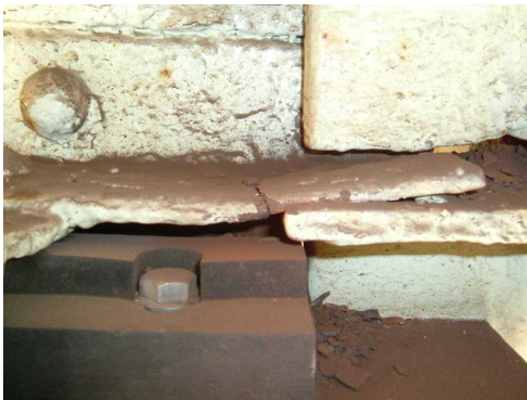
図6 P6 縦桁下フランジ変状の様子
