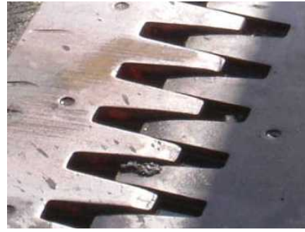
図3 P6 支承付近伸縮装置段差
