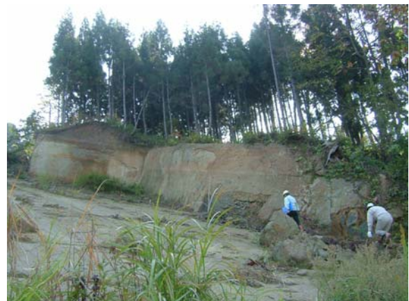
図-2 横渡地区 A 地区崩壊地
