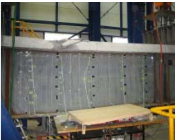
写真-1 正曲げ試験体の圧壊状況
