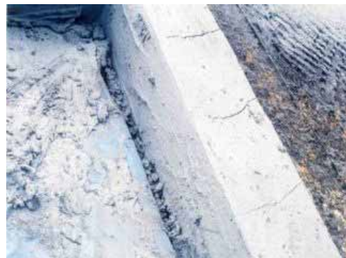
写真 4 副産物混入モルタルのひび割れ状況
