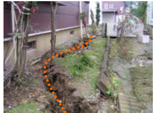
写真-1 住宅Fからのクラック1 (図-3.9-o)
