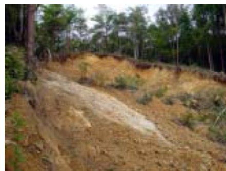
図3 中山の斜面崩壊(崩壊上部)
