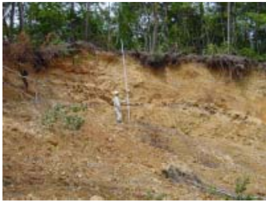
図4 中山の斜面崩壊の様子
