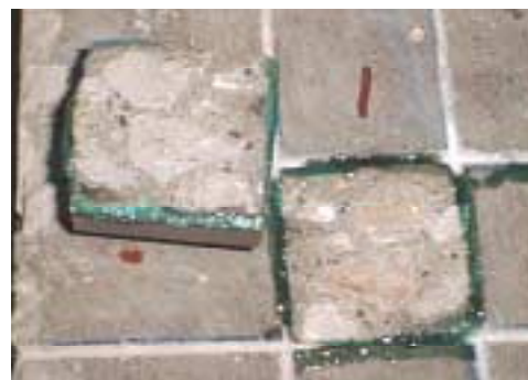
写真-2 タイプAの破壊状況
