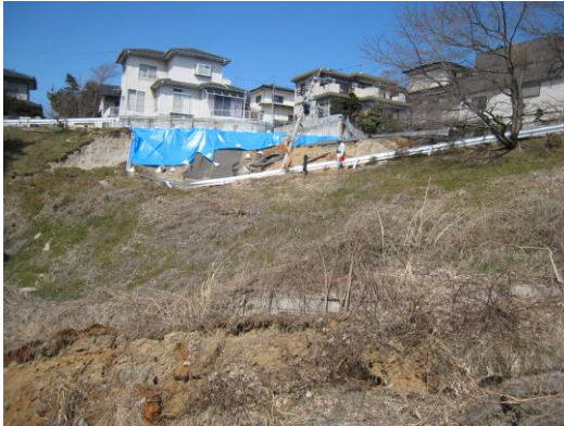
写真 4.3.2_6 No.2 の崩壊の下部
