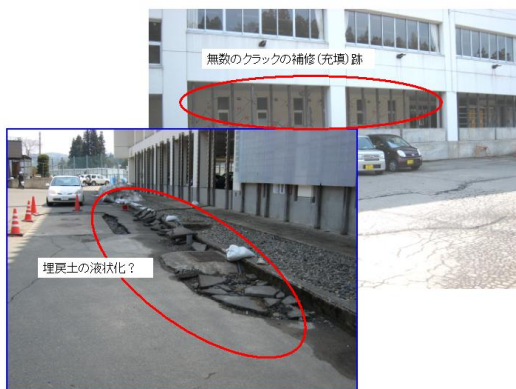
写真 4.3.3_7 栄小学校の被害(図 4.3.3_6 の No.2 の箇所)
