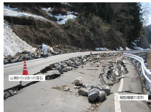
写真 4.3.3_10 箱型擁壁の被害(図 4.3.3_6 の No.4 の箇所)
