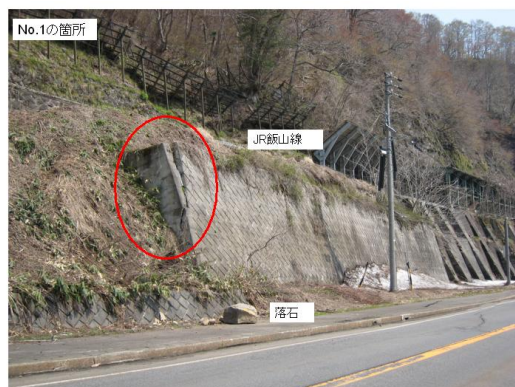
写真 4.3.3_4 JR 飯山線の盛土の被害 (図 4.3.3_5 の No.1 の箇所)
