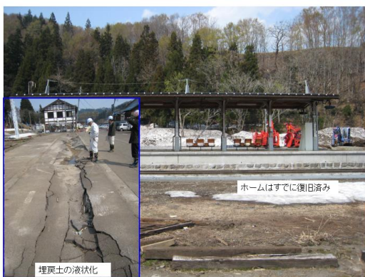
写真 4.3.3_12 森宮野原駅の被害 (図 4.3.3_6 の No.5 の箇所)
