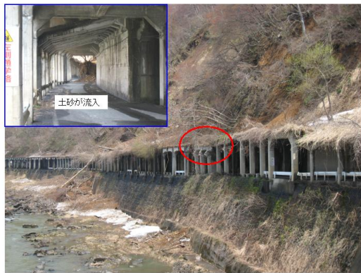
写真 4.3.3_6 覆道の被害(図 4.3.3_6 の No.1 の箇所)
