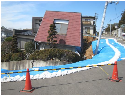
写真 4.3.2_7 No.2 の崩壊の上部
