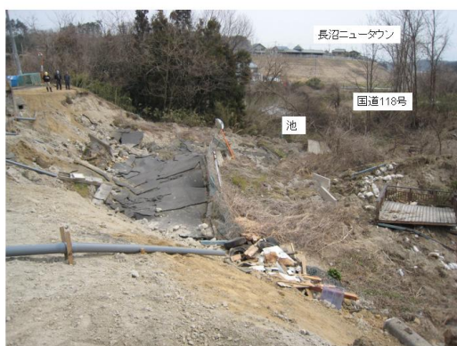
写真 4.3.2_9 崩壊上部から下方向
