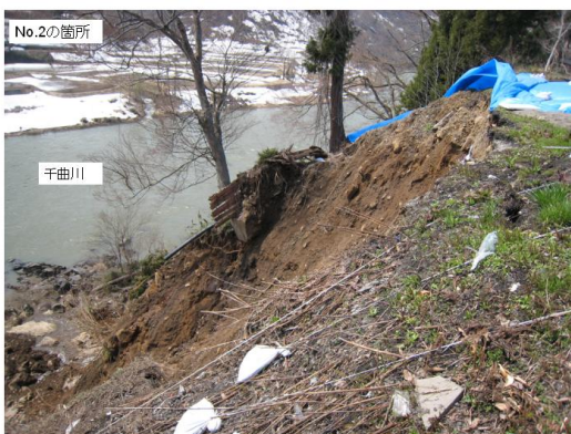
写真 4.3.3_5 国道 117 号の被害箇所 (図 4.3.3_5 の No.2 の箇所)
