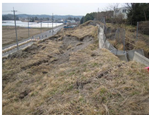
写真 4.3.2_12 No.1 の盛土被害
