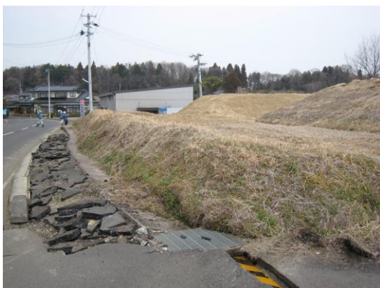
写真 4.3.2_15 No.3 の盛土被害
