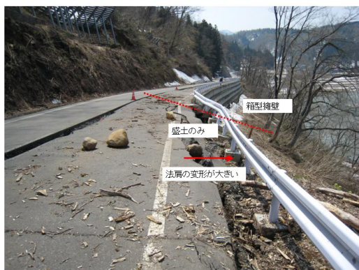
写真 4.3.3_11 道路の被害 (図 4.3.3_6 の No.4 の箇所)
