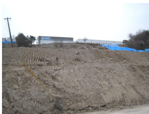
写真 4.3.2_13 No.2 の盛土被害 (崩壊下部から)
