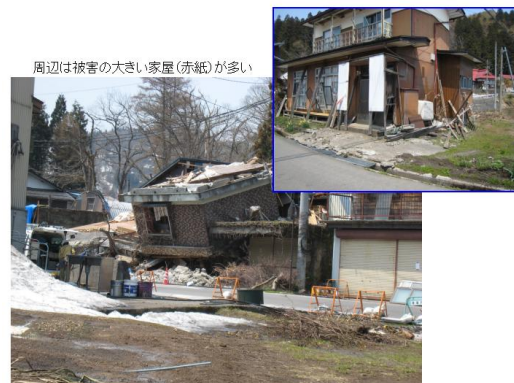
写真 4.3.3_9 民家の被害(図 4.3.3_6 の No.3 の箇所)
