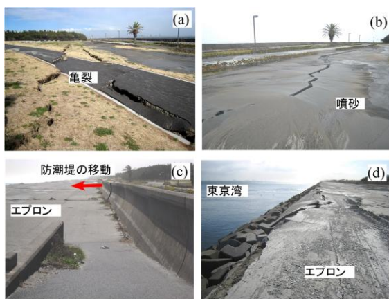
写真-4.3.1_1 浦安市墓地公園の被害
