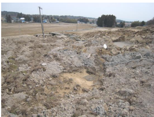
写真 4.3.2_14 No.2 の盛土被害（崩壊上部から）
