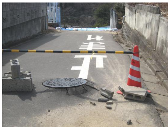
写真 4.3.2_4 崩壊地後方のマンホール
