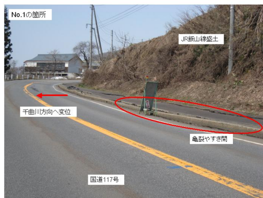
写真 4.3.3_3 国道 117 号の被害 (図 4.3.3_5 の No.1 の箇所)
