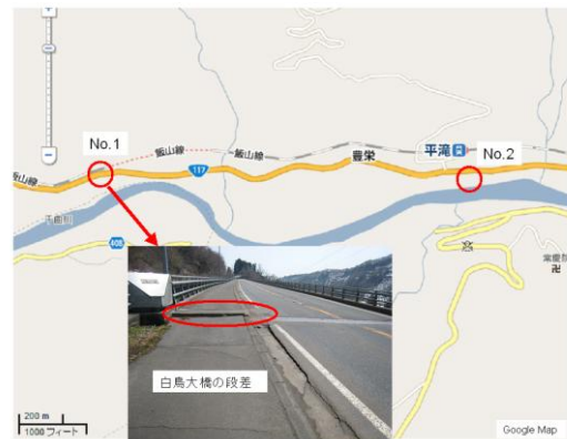
図 4.3.3_5 栄村豊栄の国道 117 号の被害箇所
