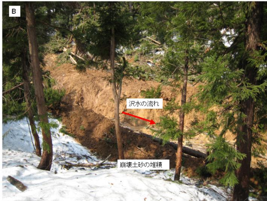
写真 4.3.3_1 セツケ巻の崩壊 (図 4.3.3_4 の B 地点)
