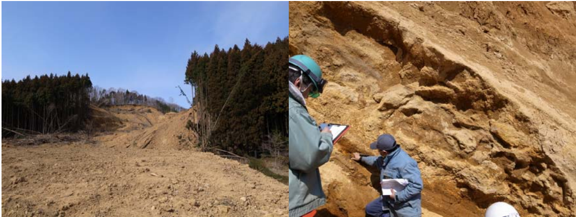
図 2.8 福島県葉ノ木平地区の斜面崩壊とすべり面の露頭（環境防災研究室）
