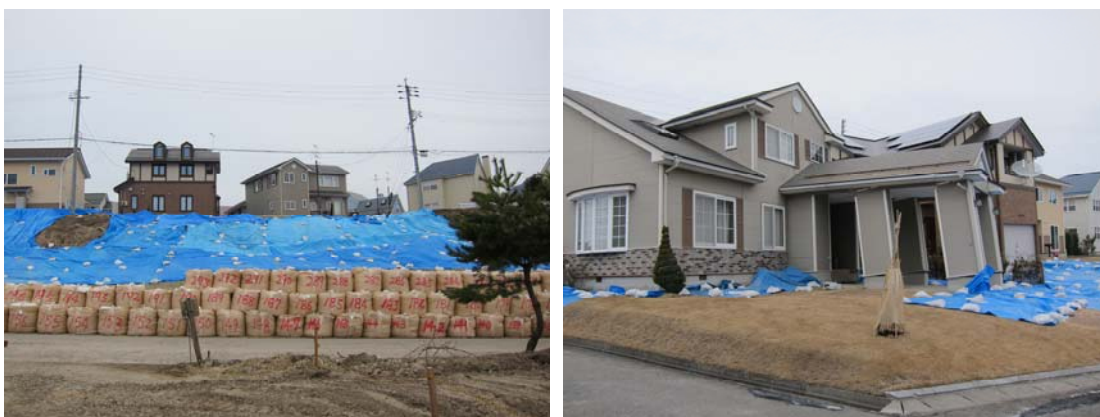
図 2.9 火山性堆積物による盛土の被害（環境防災研究室）
