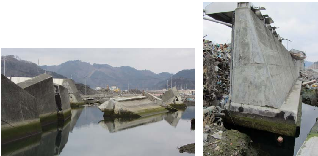
図 2.9 防潮堤の転倒被害と基礎地盤の浸食（環境防災研究室）
