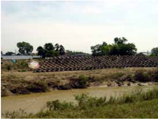
口絵 5-12 破堤箇所の表のり面
