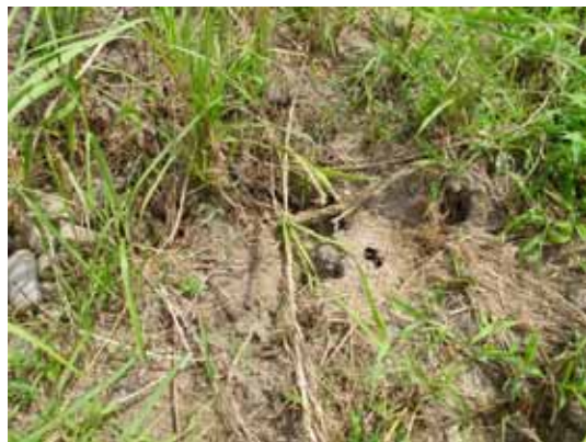
口絵 5-15 猿橋川堤体のパイピング跡
