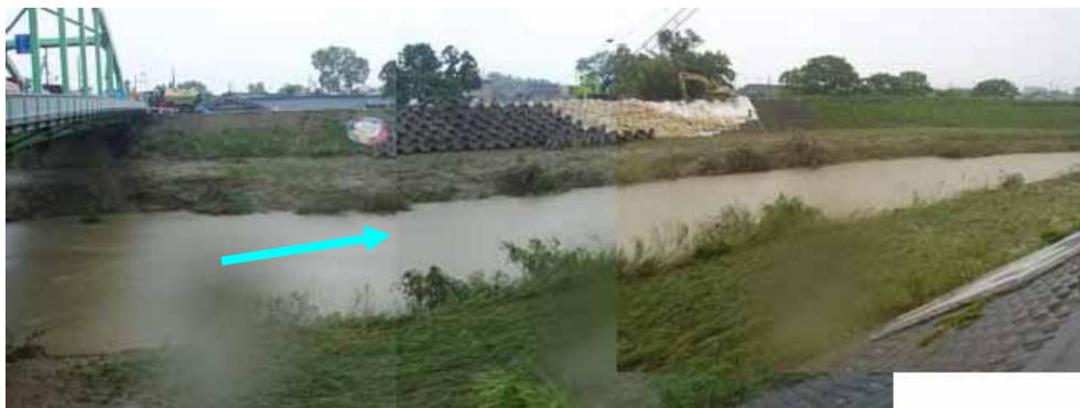
写真 4-10 破堤箇所（平成 16 年 7 月 17 日） （刈谷田川右岸より左岸方向）
