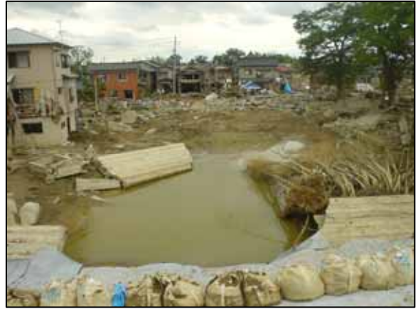
写真 3-5 中之島町破堤現場の落ち堀り 土木学会調査団 7.19 撮影
