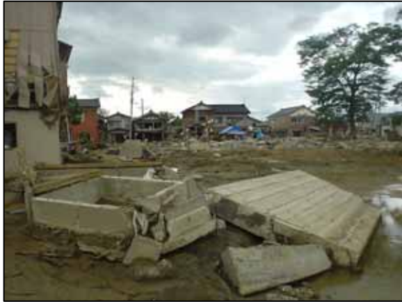
写真 3-4 中之島町破堤現場 土木学会調査団 7.19 撮影
