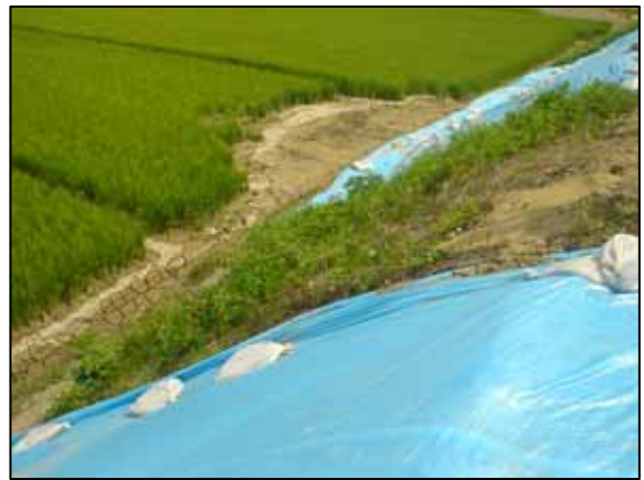
写真 3-7 稚児清水川左岸堤防端部 土木学会調査団 7.19 撮影
