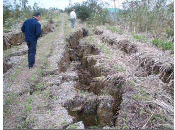
(写真2) 堤防天端の亀裂(左岸:中之島町大字中之島)
