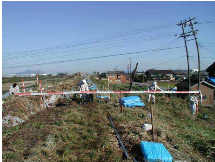
(写真3) 堤防法面の流動(右岸:見附市山吉町)
