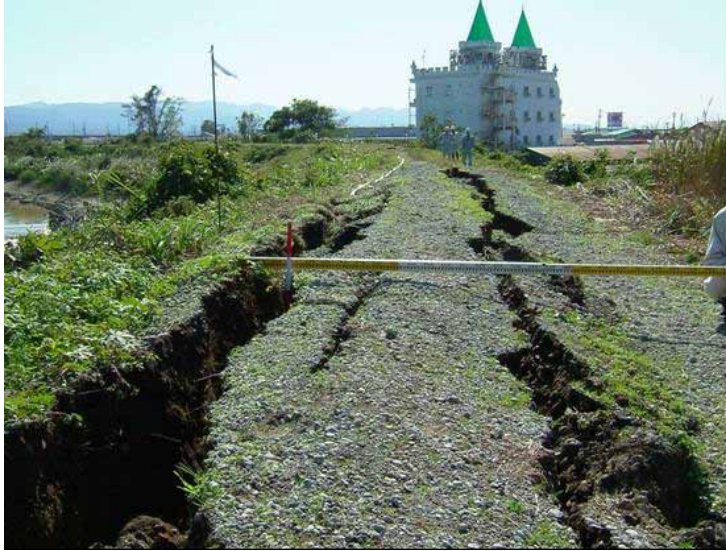
(写真1) 堤防天端の亀裂(左岸:見附市山吉町)
