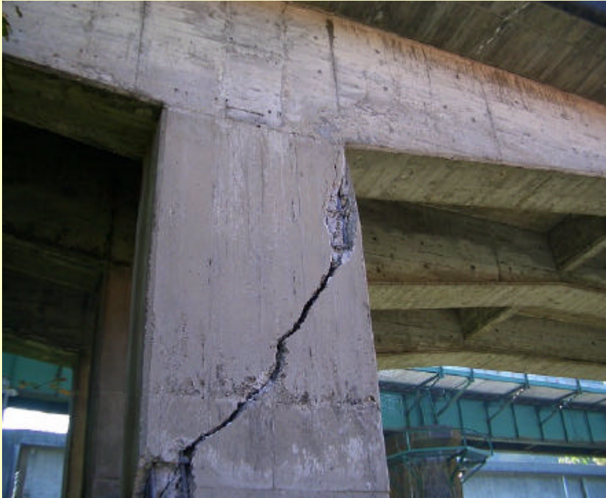
斜めひび割れ(C1:旧浦柄橋)
