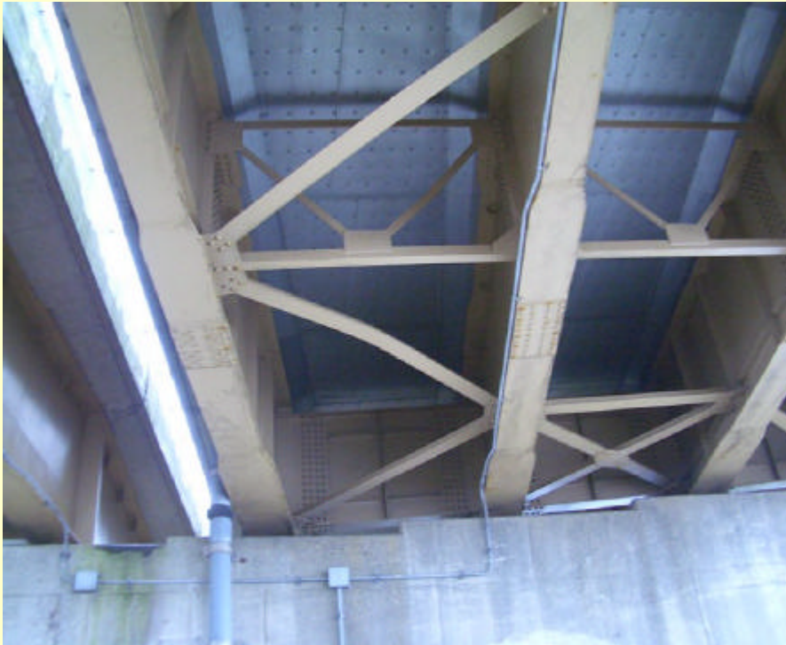
横構の変形(S1:十日町高架橋)
