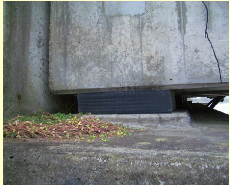
ゴム支承(C5:四日市橋)
