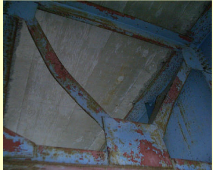
対傾構の変形(S2:越の大橋)
