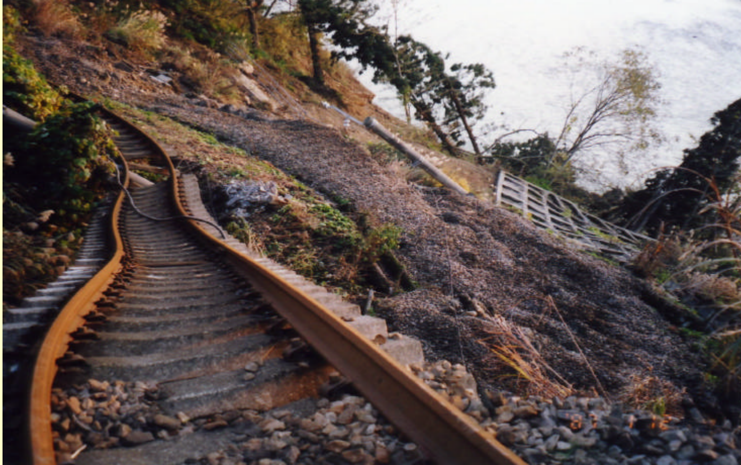
上越線(下り)天王トンネル脇の斜面崩壊 (川口町天納)
