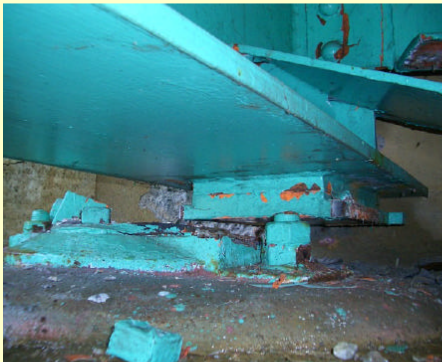
支承部の破損(S12:竜光1号橋)
