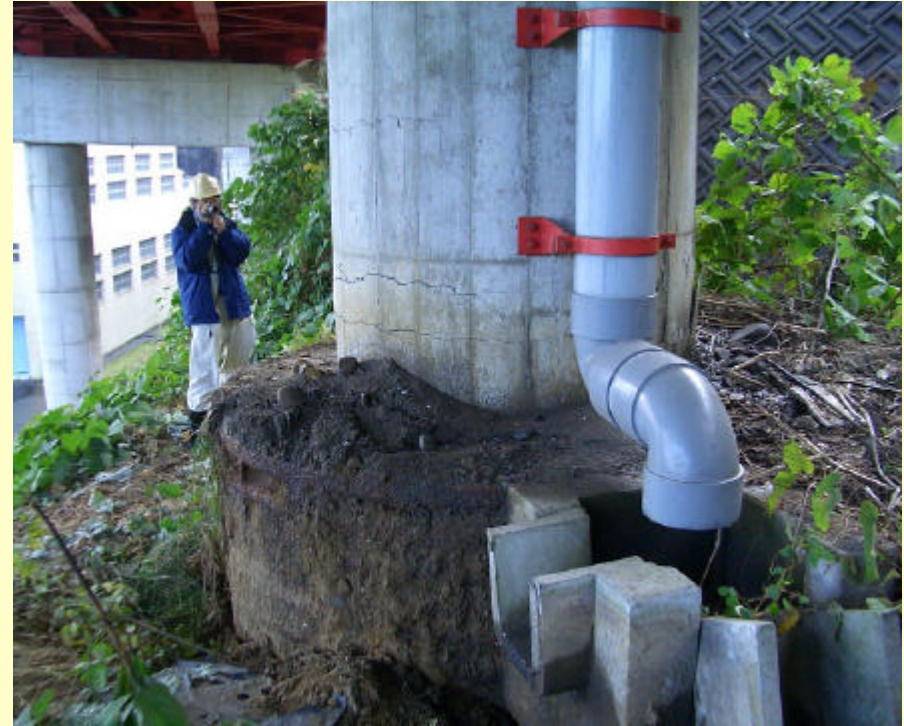
土砂の流出(S5:山辺橋)
