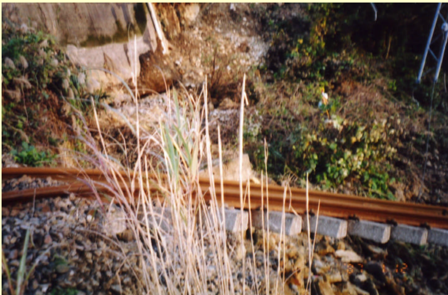
上越線(下り)天王トンネル脇の斜面崩壊 (川口町天納)
