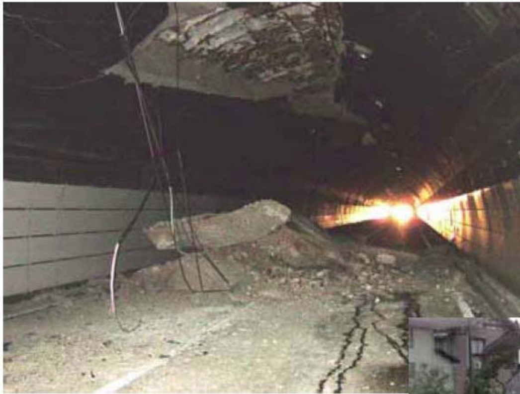
国道17号 川口町和南津トンネル コンクリートの崩落 (H16 .10 .24 撮影)
