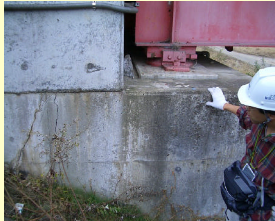
桁移動による損傷(S10:宇賀地橋)
