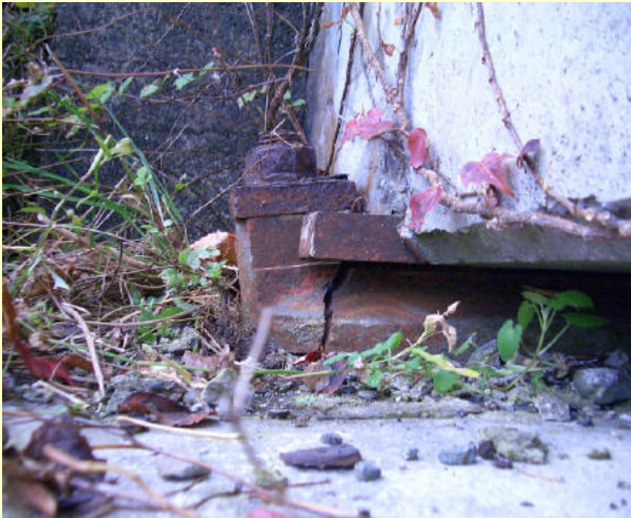
下沓ストッパーの破断 (C5:旧四日市橋)
