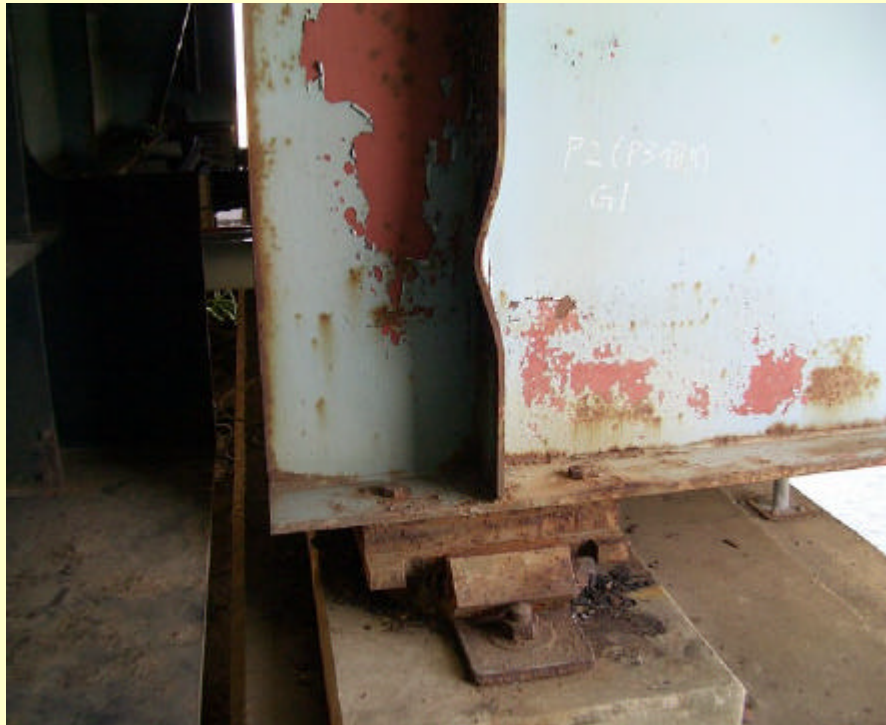
垂直補剛材の座屈(S2:越の大橋)
