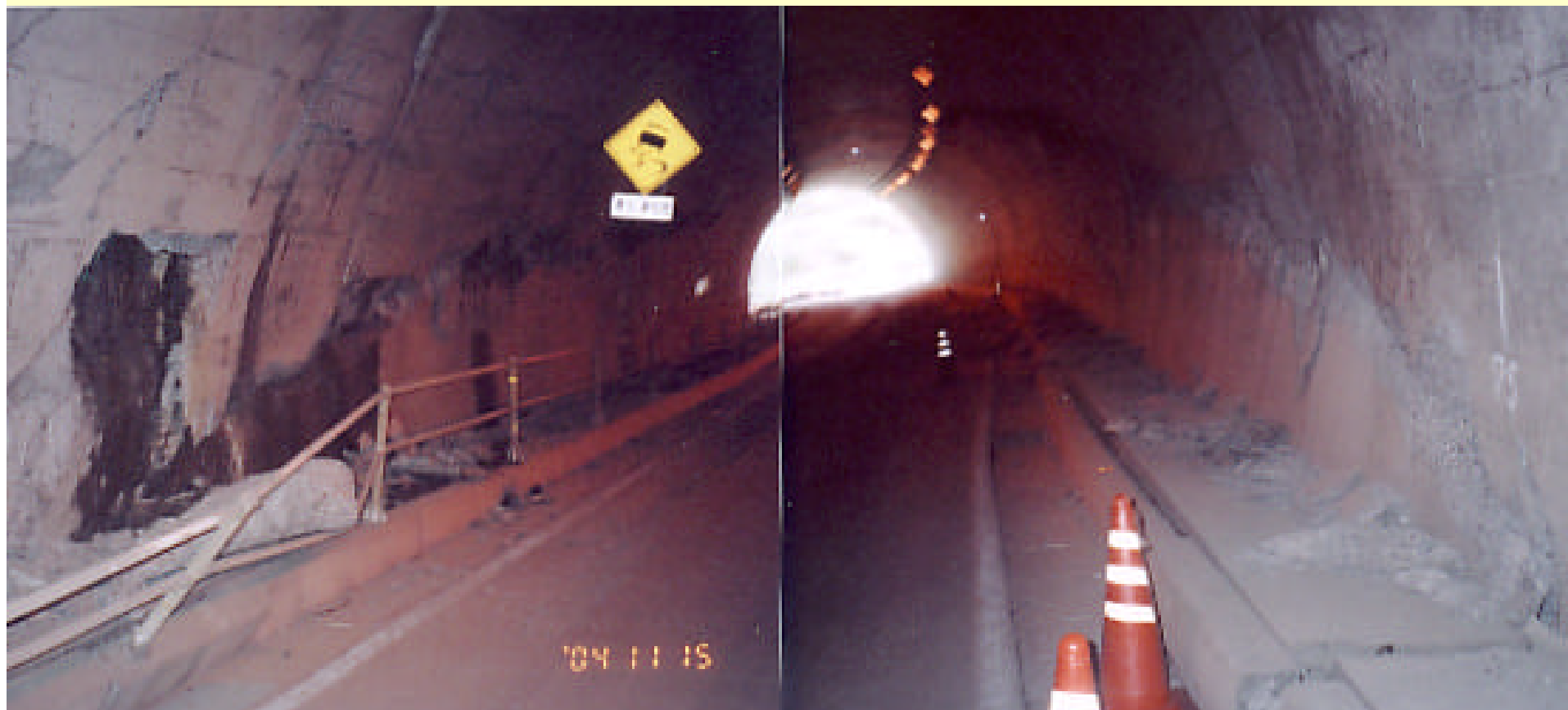
県道71号線木沢トンネルの被害 (川口町木沢)
