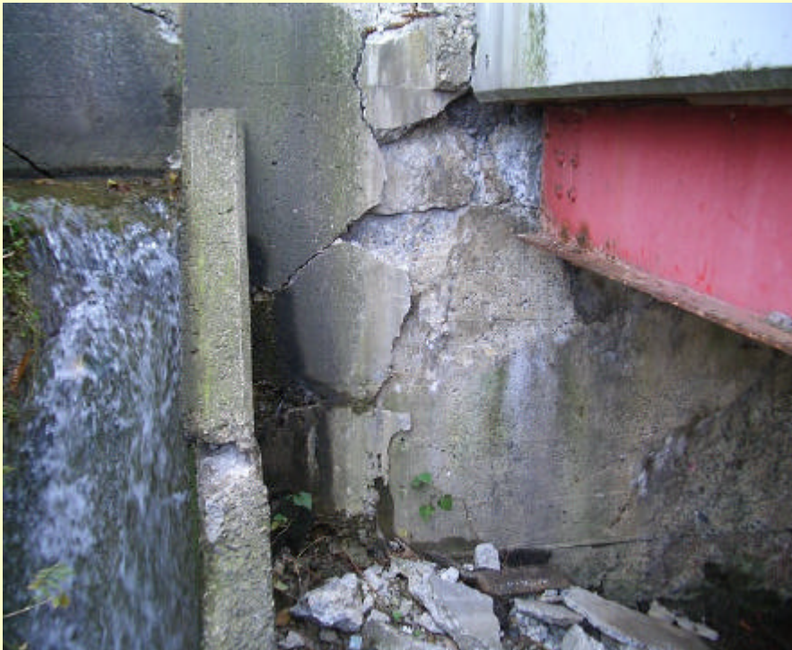
桁衝突による損傷(S9:和南津橋)
