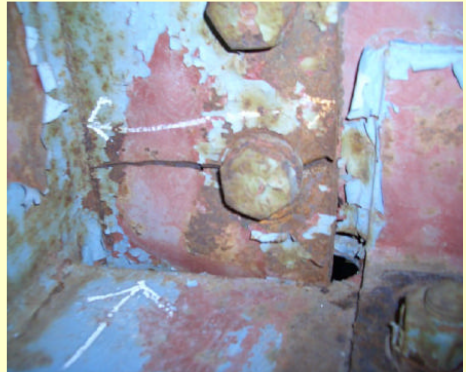
垂直補剛材の割れ(S2:越の大橋)
